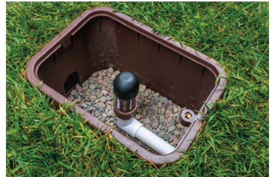
Válvula de alívio de vácuo/ar instalada
