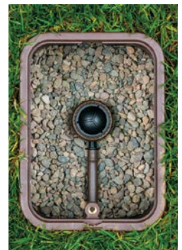
Válvula de descarga automática instalada
